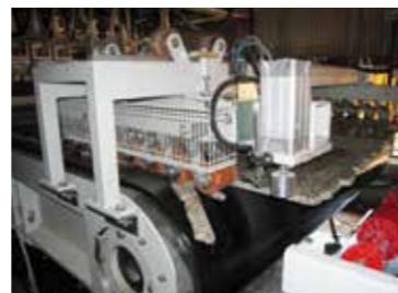
3 Rottura sfrido Waste crushing unit
